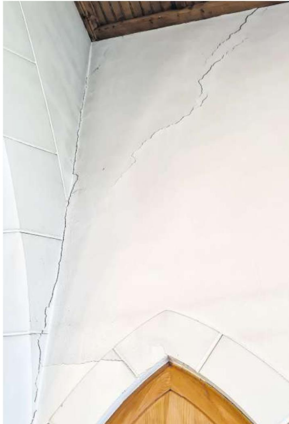
Risse ziehen sich durch das Chorgewölbe.
