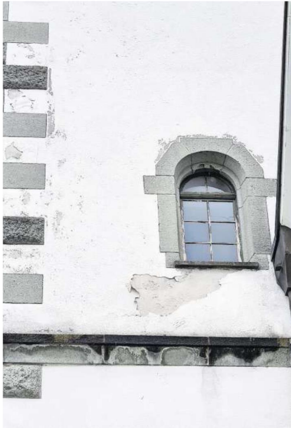
Abblätternder Verputz am Grabser Kirchturm.
