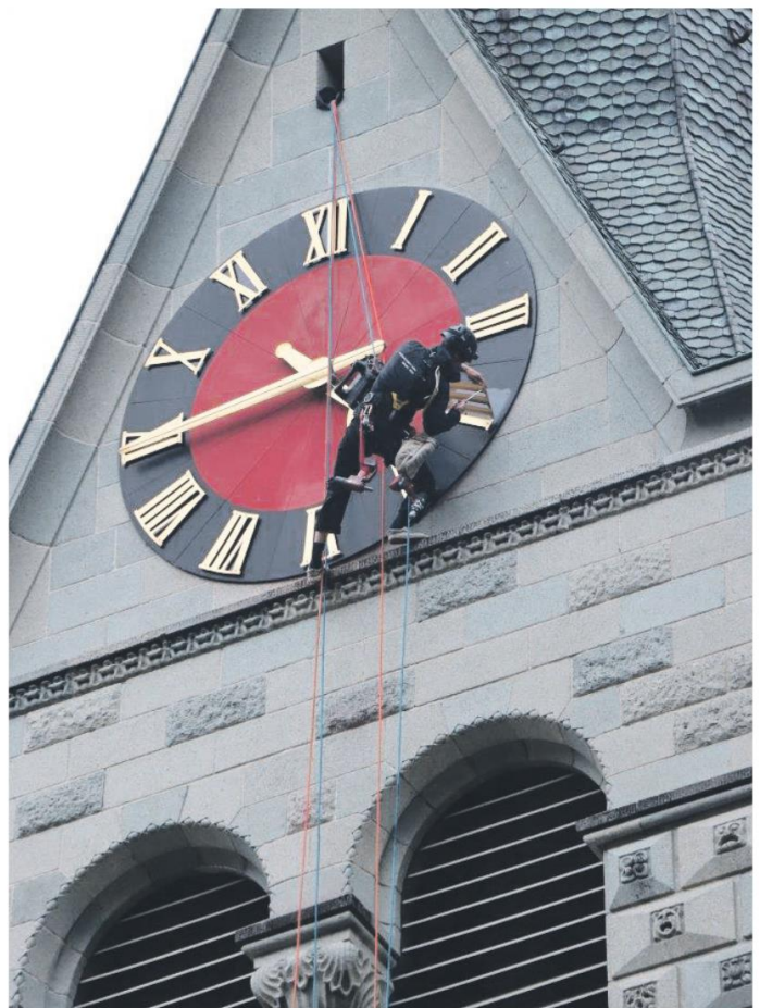
Ein Profi der Grabser Firma Höhenarbeit bei der Reparatur des Zifferblattes in luftiger Höhe.
